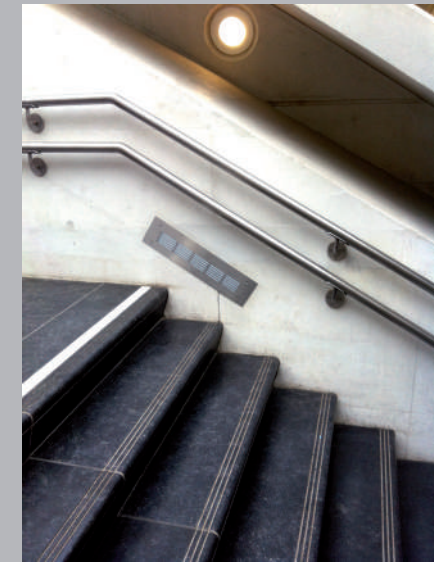
✓ De dubbele leuning loopt voldoende ver door bovenaan de trap
