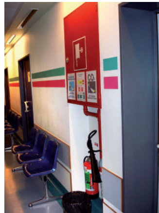
✓ Brandblusapparaat aangebracht in een nis
