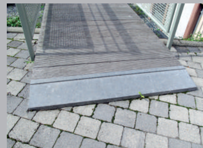
✗ Drempel aan het begin van de toegangsweg
