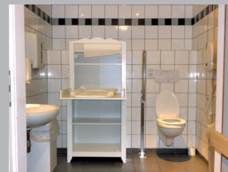
✗ Transferruimte die versperd is door een verzorgingstafel en zich niet in de as van de deur bevindt
